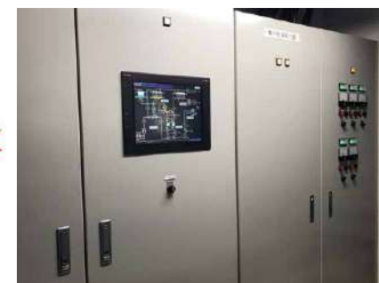
集中給湯動力盤
